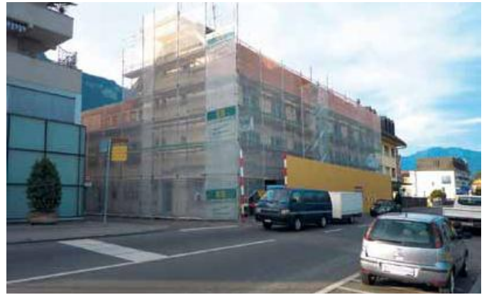
Une année après l'obtention du permis de construire, le promoteur a enfin lancé le début des travaux du restaurant Le Vieux-Pêcheur à l'entrée de Villeneuve.
